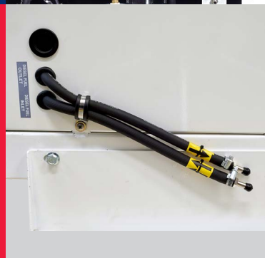
Ingresso e uscita gasolio
